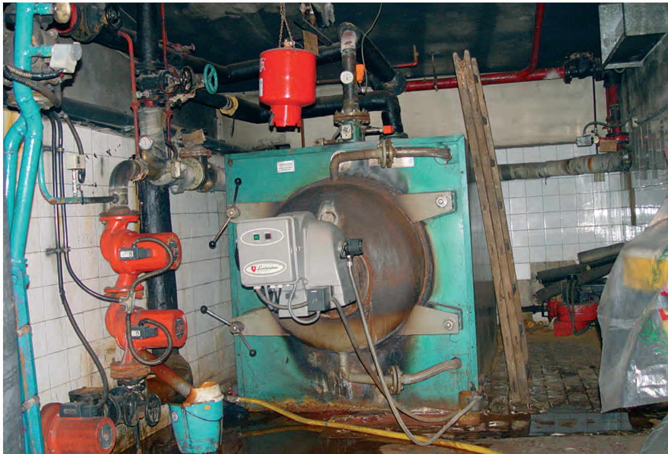
El buen mantenimiento de las calderas de calefacción es fundamental para ahorrar energía.
