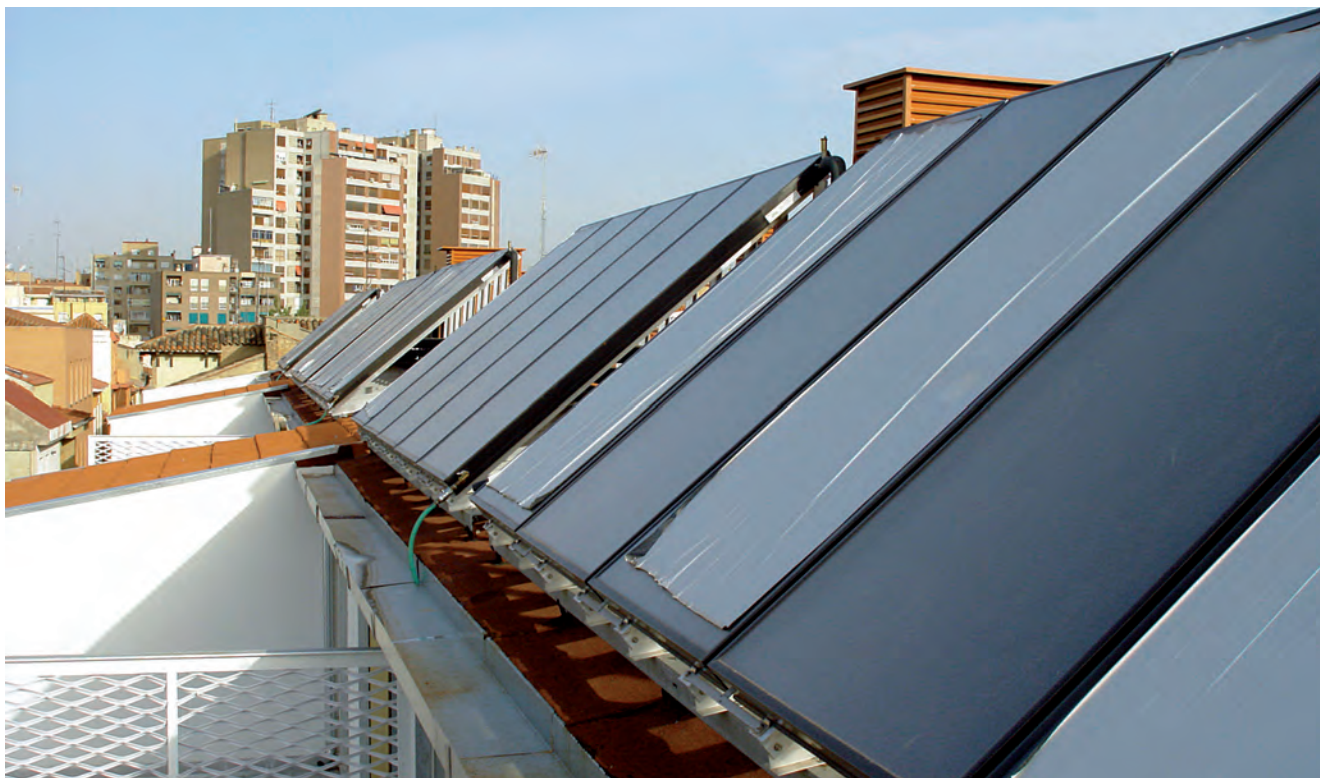
Placas solares para agua caliente en nuevas actuaciones municipales, en el caso histórico de Zaragoza.
