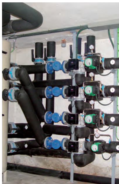
Sistemas de control en una reforma de calefacción.
