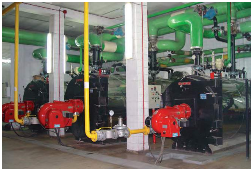
Sala de calderas.
