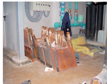
Efectos de la falta de control.
